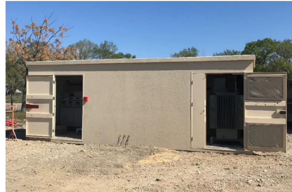
Figure 7 : Photographie d'un poste de livraison/transformation
